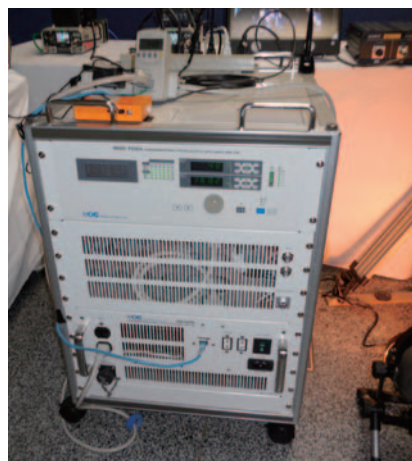
写真7 燃料電池を使った無停電装置
