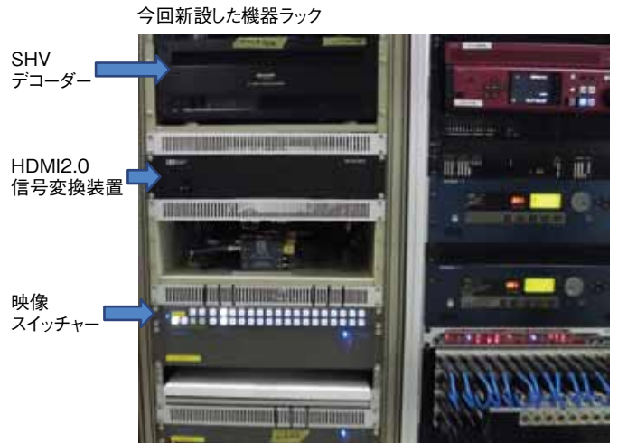
写真2 整備した機器ラック
